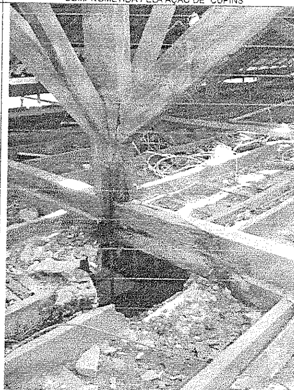
FORRO DE ESTUQUE COM SUJEIRA ACUMULADA E ESTRUTURA DE MADEIRA COMPROMETIDA PELA AÇÃO DE "CUPINS". FIOS E CABOS ANTIGOS REVESTIDOS DE TECIDOS, SOLTOS POR CIMA DO FORRO.
